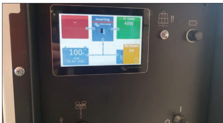
Alimentata da tre pannelli solari da 400W ciascuno = energia continua anche senza rete elettrica e autonomia per diversi giorni anche con scarsa insolazione
